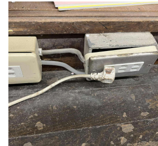
壊れたコンセントBOX
