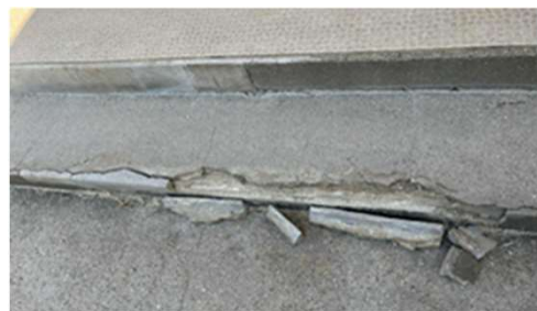
角が崩れた外階段
