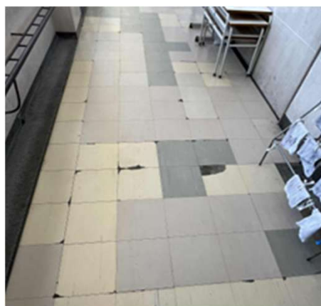
補修でパッチワーク状になっている廊下
